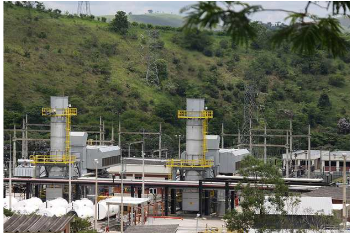
Figura 1.24 – Imagem fotográfica da termoelétrica situada em Juiz de Fora – SP.
